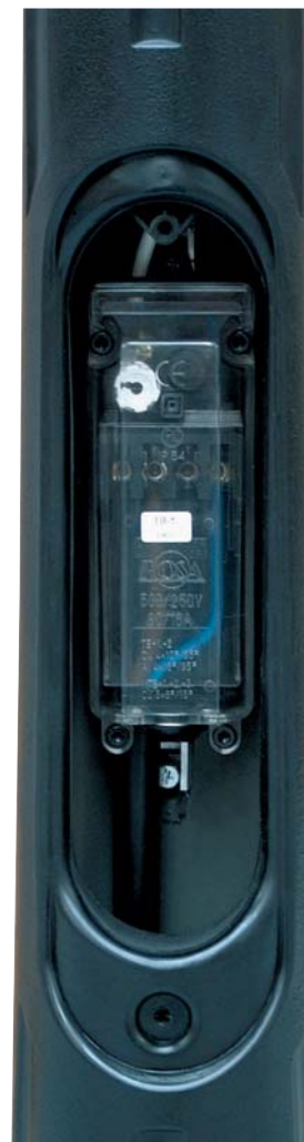
Вводный щиток в ниши стальной опоры с внешним покрытием из синтетического материала
