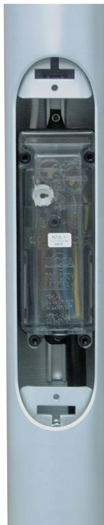
Вводный щиток в ниши алюминиевой опоры
